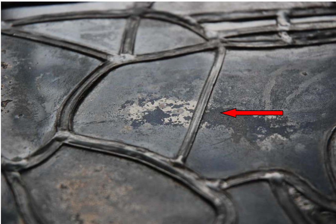
Abb. 38 London, V&A, Feld n II 1c von ~ 1380, Detail der Außenseite im Auflicht, KO 3: die obere Glasschicht ist zerstört und der originale Feuerschmelz ist verloren gegangen. Die freigelegten Oberflächen sind rau und es liegen vereinzelt Korrosionsprodukte in pudriger Konsistenz auf.
