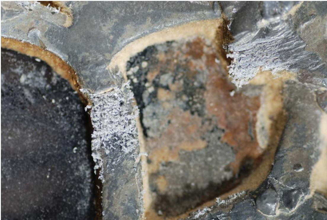
Abb. 20 München, BNM, Feld n IV 1d von ~1380, Detail der Außenseite im Auflicht, kristalline Ausblühung entlang des Bleinetzes
