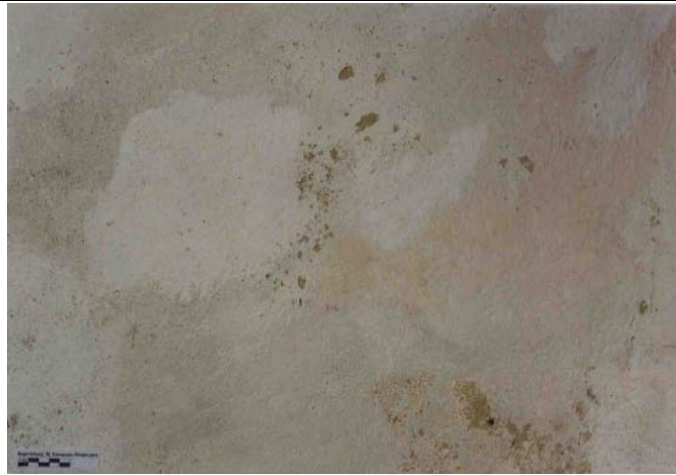
Abb. 66: Rosafarbener Befall neben Salzausblühungen. (Foto entnommen aus: Wörz 2000, S.38)
