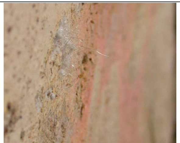
Abb. 21: Salznadeln eines befallenen Bereiches.
