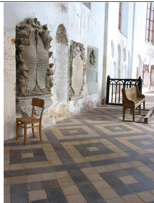
Abb. 46: Die Nordwand des Chorumgangs. Der Befall findet sich vor allem im fußbodennahen Bereich unter den Epitaphien.
