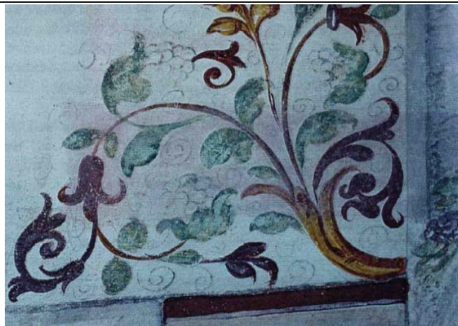
Abb. 41: Befallener Bereich der Wandmalerei. (Foto aus: Aßmann 2000, S.37)
