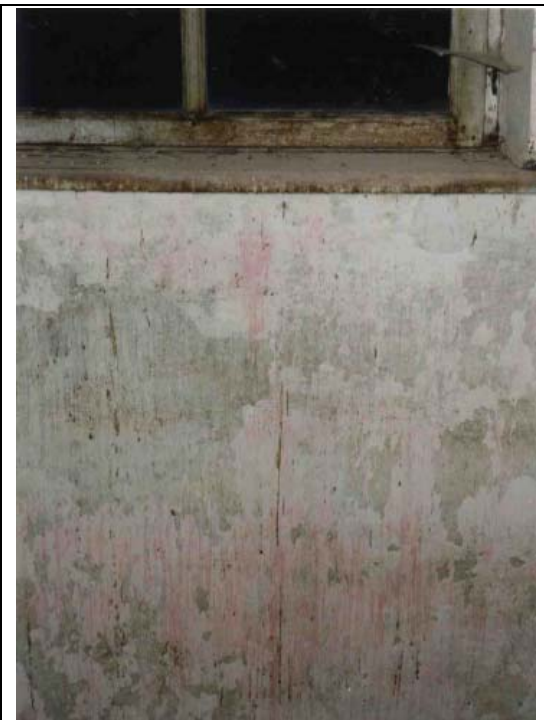
Abb. 33: Verstärkter rosafarbener Befall auf Laufspuren von Kondenswasser. (Foto aus: Wörz 2000, S.33)
