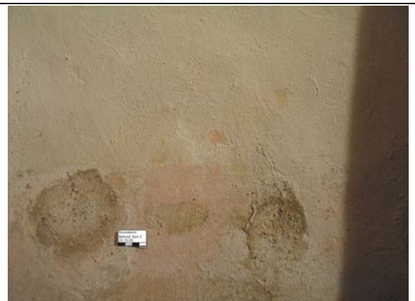
Abb. 24: Dunkle Verfärbungen rund um die verschlossenen Belüftungsröhrchen.
