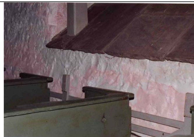
Abb. 58: Rosafarbener Befall unter der Empore der Nordwand. Hinter dem an die Wand gelehnten Gatter ist der Befall besonders stark ausgeprägt. (Foto aus: Sievers 2002, Abbildungsteil S.2)
