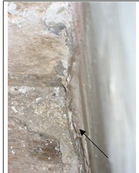
Abb. 50: Nadeliger Salzrasen in einem Eckbereich der Sakristei.
