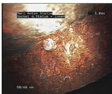
Abb. 235: MA-M, Plinthe, stark korrodierte Schraubverbindung
