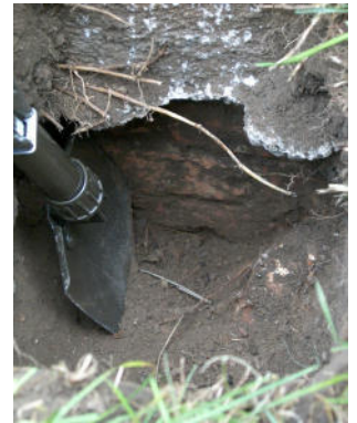
Abb. I55: MA-M; Sockelverputz endet im Erdreich, Baumwurzel
