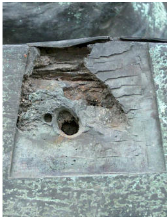
Abb. 45: Marc Anton-Monument, 2002, Plinthe, abgesprengte Flicke; durch Korrosion von Eisen im Inneren abgesprengter ehemals geflickter Bereich. Der im Guss nicht ausgeflossene Bereich und die mechanisch ausgearbeitete Geometrie der ehemaligen Fügenaht sind ersichtlich.
