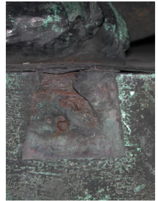
Abb. I51: MA-M, fehlende Originalflicke an der Plinthe, Sprengung der Bronze durch Eisenkorrosion. Das vorzeitige Erstarren der geschmolzenen Legierung in der Gussform (Gussfehler), die mechanische Vorbereitung dieses Bereiches für das Anfügen einer Bronzeflicke, sowie die zur Absprengung führende Eisenkorrosion ist ersichtlich.
