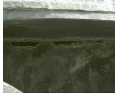
Abb. 287: MA-M, Thronwagen-Unterseite, Nord-West: Feuchtigkeit tritt auch aus dem Inneren des Thronwagens durch undichte Fugnähte heraus
